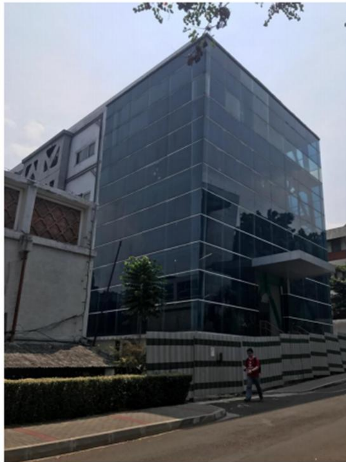
Gambar 3.17. Gedung PPTI-FTMD Memerlukan Penanganan Teknis Lebih Lanjut
