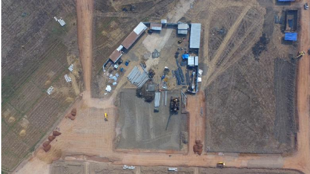
Gambar 3.25. Foto Udara Pembangunan Kampus ITB Cirebon
