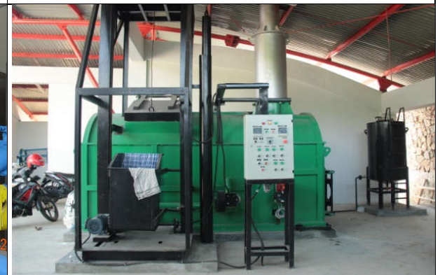
Instalasi Pengolahan Sampah
