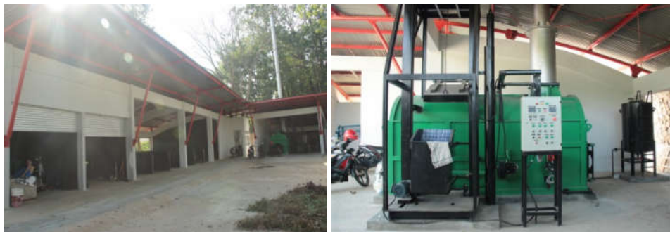
Gambar 3.24 Instalasi Pengolahan Sampah
